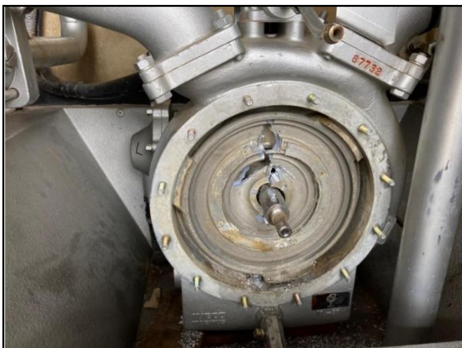
Schaden am Leitrad der Pumpe
